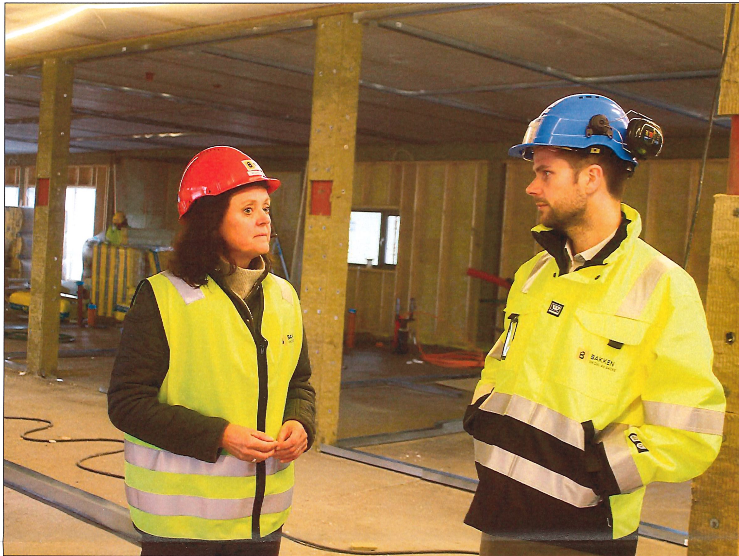
FYLLES OPP: Det nye bo- og aktivitetshuset på Flisa skal fylles opp, og nå er byggherren i gang med det innvendige arbeidet. Berit Løvstad er fornøyd med det Erik Persheim i Martin M. Bakken viste fram på befaring torsdag.
